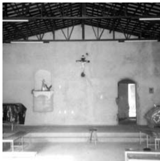
Figura 5 I danni del nubifragio all'interno della chiesa
